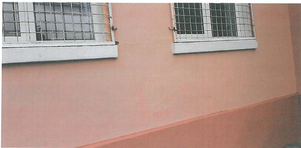
Fisura orizontala in spaleti de zidarie intre ferestre, fisura situata la baza ferestrei-vedere exterioara
