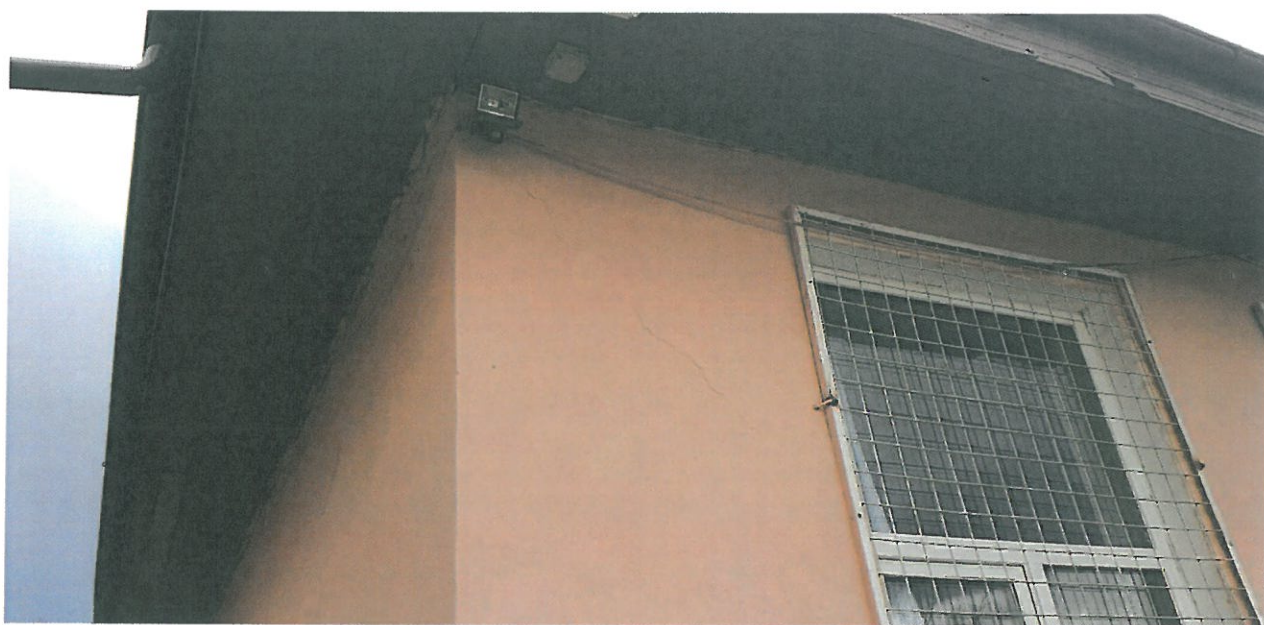
Fisura inclinata zona colt axele 2/D L34/T8 probabil din cedare de reazem produsa de infiltrarea apei, vibratii si cedare fundatie nearmata-vedere din exterior
